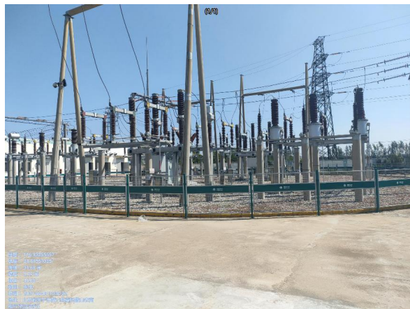
图 4-9 110kV 敞开式户外配电装置
