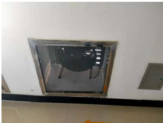
图6-4 110kV GIS 室排风扇
