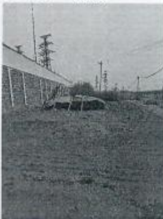
图11 潍坊奎阳220kV变电站南侧
