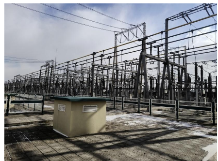
图 4-15 泉河站 110kV 配电区
