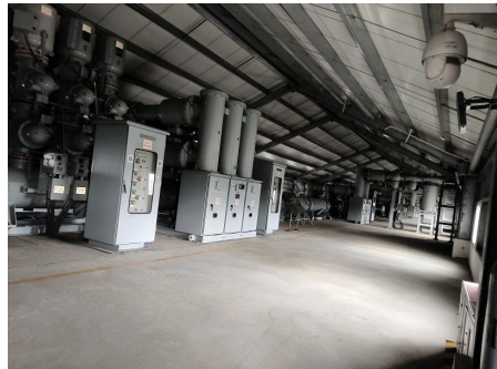
图 4-16 泉河站 220kV GIS
