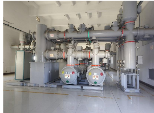
图 4-20 盘阳站 220kV GIS
