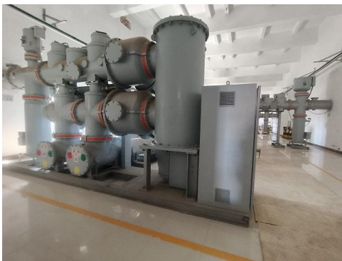
图 4-19 盘阳站 110kV GIS
