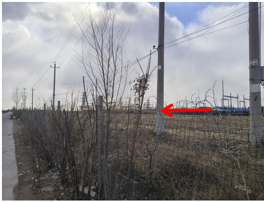
图 4-3 泉河 220kV 变电站东侧
