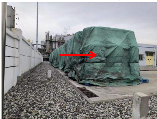
河口110kV变电站西侧
