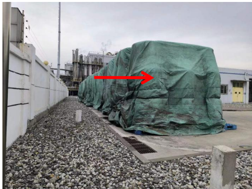
图 4-5 河口 110kV 变电站西侧
