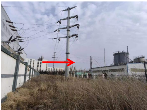
图 4-4 河口 110kV 变电站南侧
