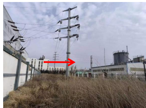
河口110kV变电站南侧
