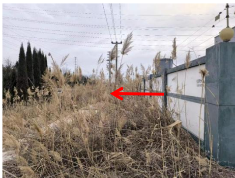
河口110kV变电站东侧
