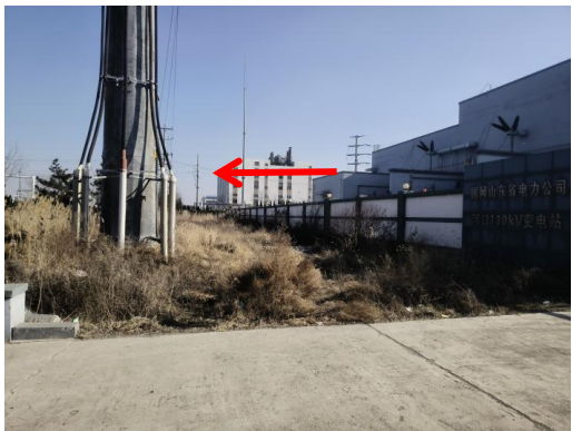
图 4-6 河口 110kV 变电站北侧
