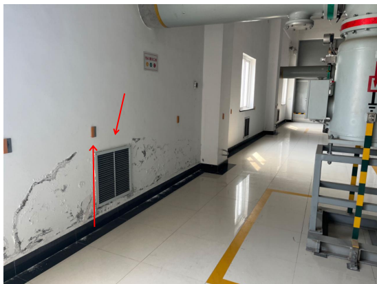
图 6-6 110kV GIS 室通风
