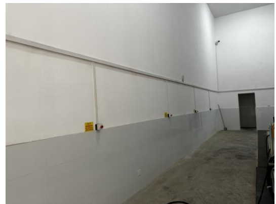
探伤室内紧急停机按钮（南墙）
